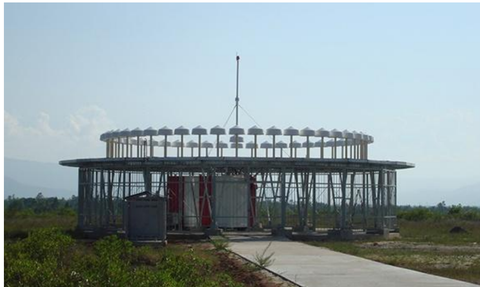
Hệ thống đài VOR/DME ATTECH đang quản lý và khai thác trên toàn quốc
