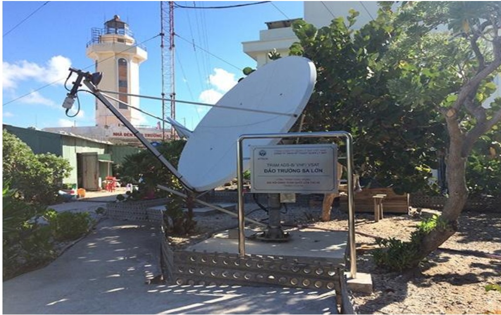
02 Trạm VHF/VSAT ATTECH quản lý và khai thác tại Đảo Trường Sa Lớn và Song Tử Tây
